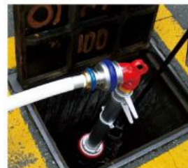
スタンドパイプとホースをつなぐ
